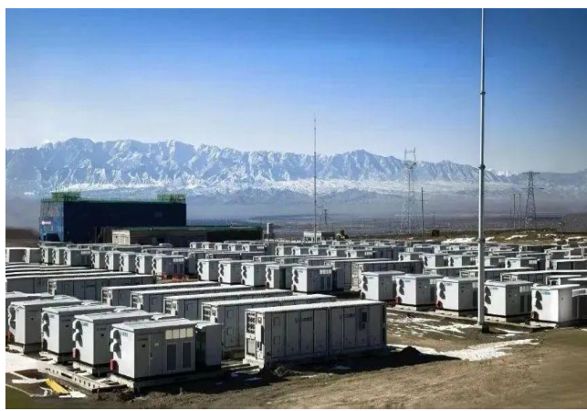
图 34：中核嘉峪关 500 兆瓦/1000 兆瓦时独立储能项目
