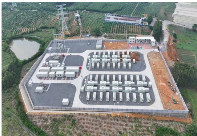
图 30：华润电力广西贺州富川集中式共享储能电站
