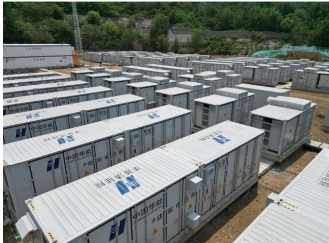
图 23：华能山东莱芜分散控制构网型独立储能电站
