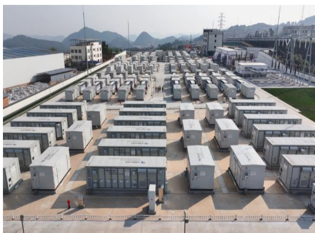
图 16：南网储能宝池储能站
