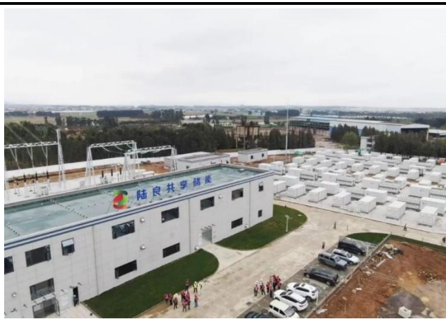
图 20：国家电投集团云南国际陆良共享储能项目
