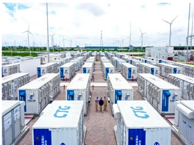
图 14：国网江丰储新型储能电站
