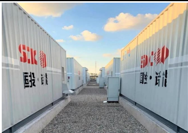
图 32：国投盐城智汇用户侧储能项目
