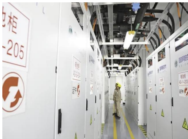
图 41：福建吉瓦级宁德霞浦储能项目
