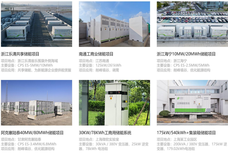
图：公司光伏储能电站项目案例
