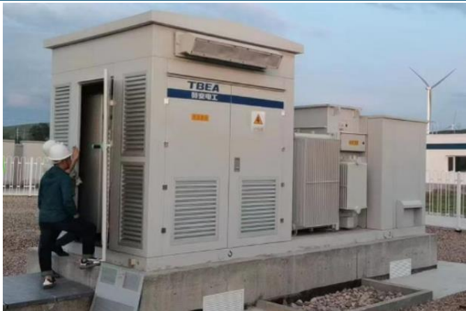
图表49：河北沽源县 400MW “光伏+储能”示范项目
