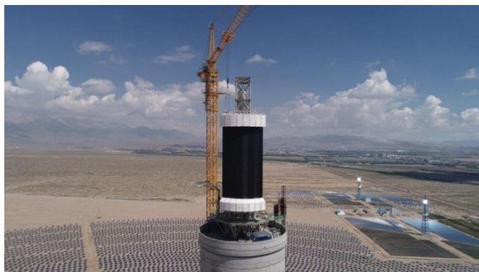
图表23: 青海德令哈 50MW 塔式熔盐项目
