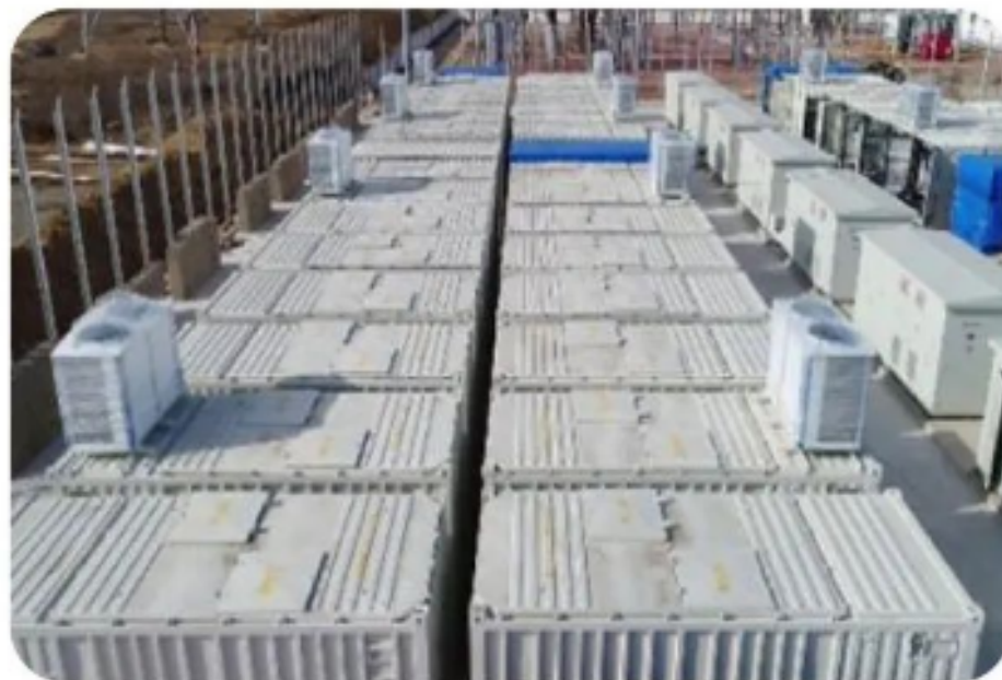
国电投驼山10MW/40MWh
