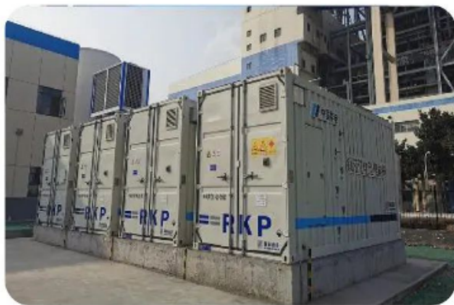
华电滕州1MW/2MWh
