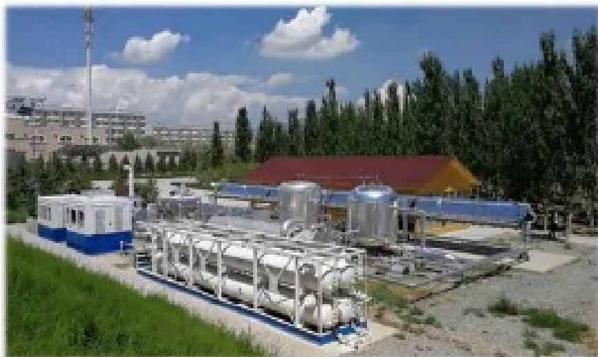
西宁100kW实验电站
