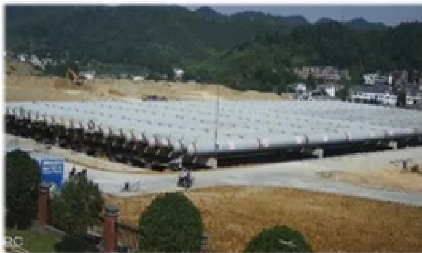
毕节10MW项目
