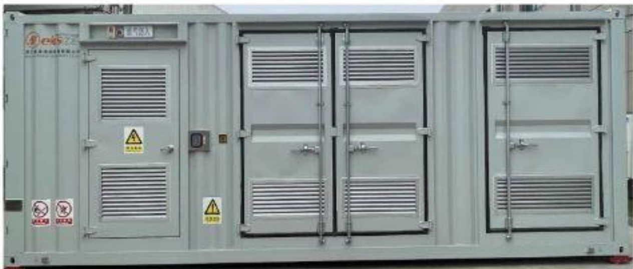
巨化集团氢储能电站
