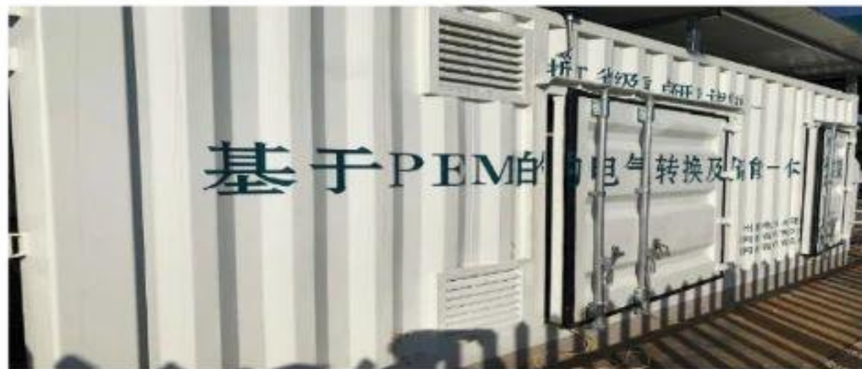
湖州综合能源站氢储能电站
