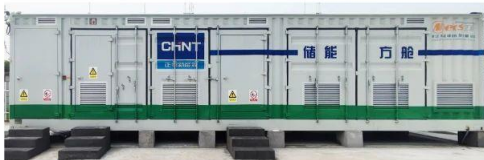
正泰新能源氢储能电站
