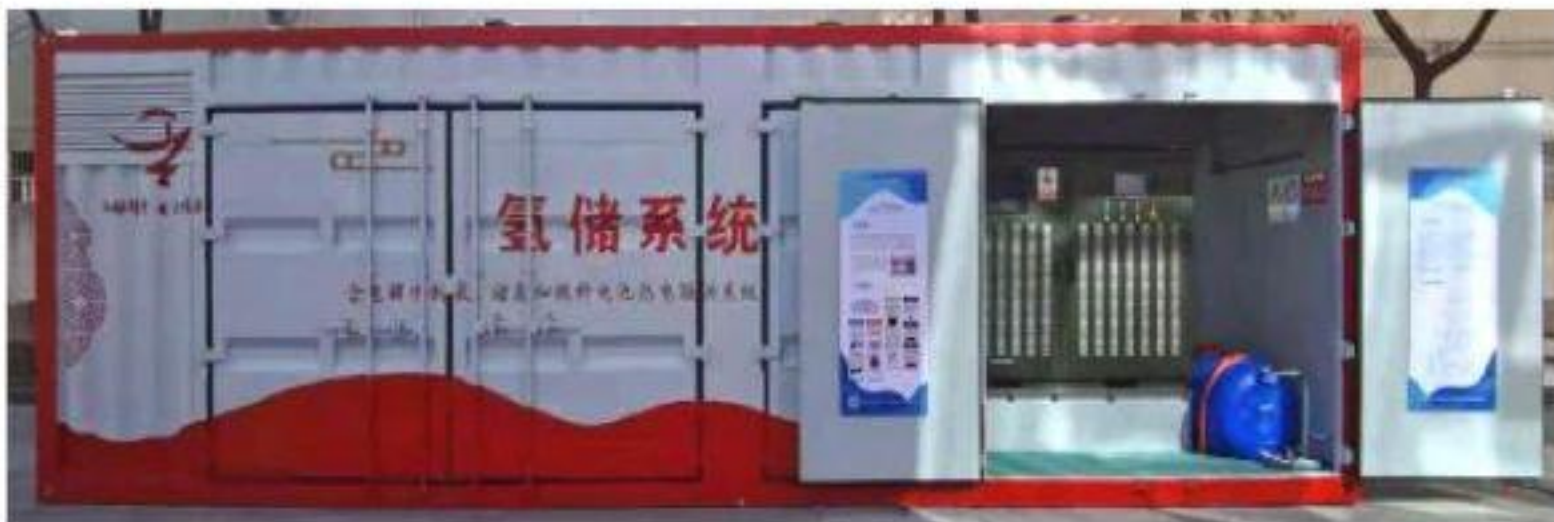
嘉兴“零碳”园区热电联供电站
