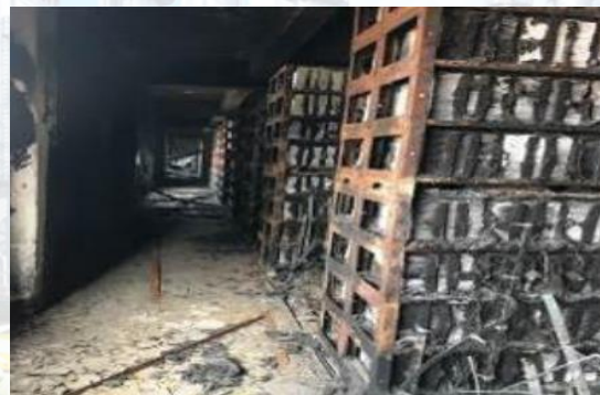
案例2：江苏某储能电站调试时正负极不小心短接，电池簇未设置熔断器，引发全站事故
