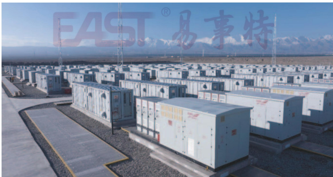
图 17 新疆克州 300MW/1200MWh 构网型独立储能项目
