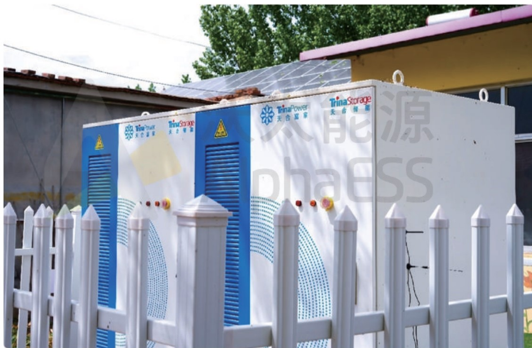
图 25 天合光能华东某地区台区储能项目
