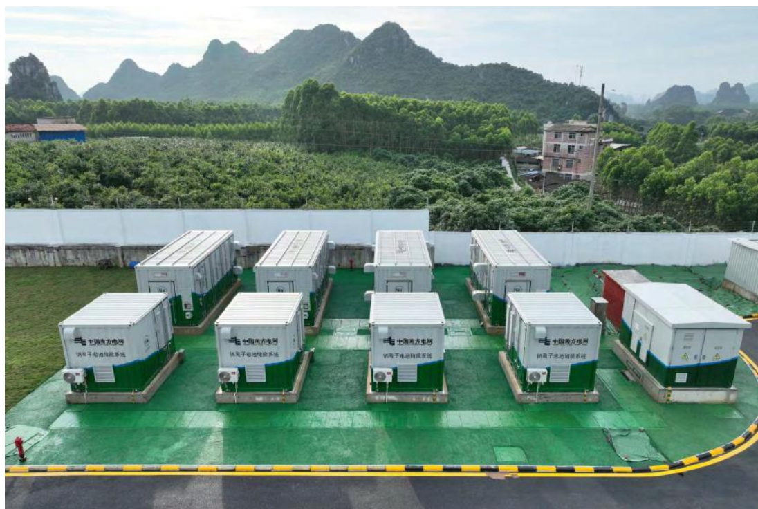
图表19：伏林钠离子电池储能电站
