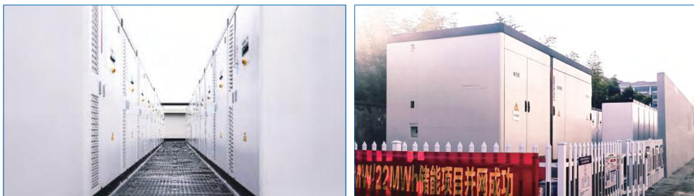
图表21：奇点能源浙江锦盛22MWh储能项目
