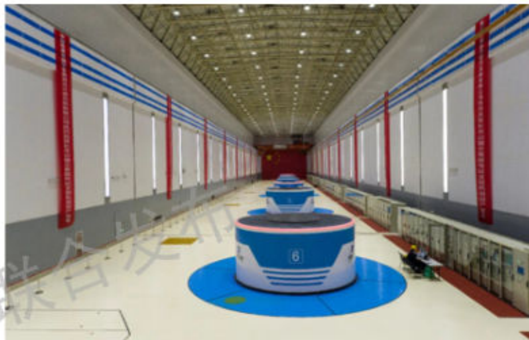
长龙山抽水蓄能电站发电机层
