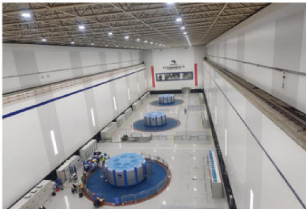
阳江抽水蓄能电站发电机层1
