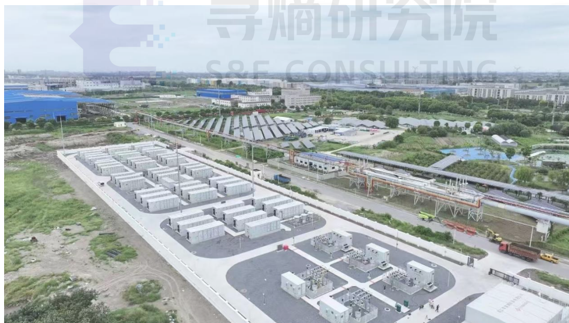
图 14 中车株洲所江苏靖江特钢 120MW/240MWh 用户侧储能项目
