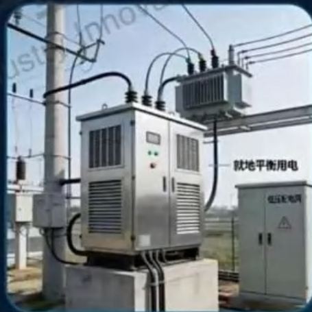
台区储能系统
