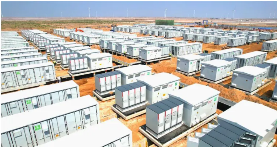
山东东营津辉795兆瓦/1600兆瓦时集中式储能项目
