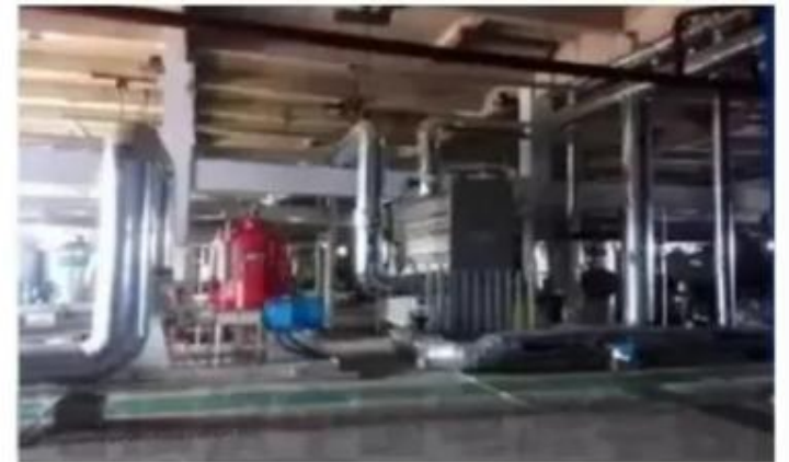
吉林风蓄储示范工程
