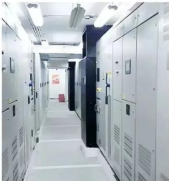
上海招商银行大厦 1MW/2.56MWH储能系 统顺利并网。
