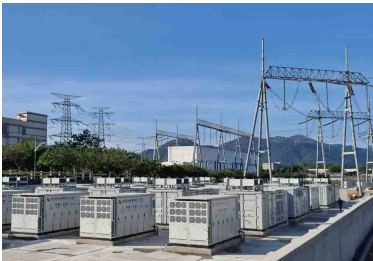
图 3.6-1 广东阳西电厂火储项目
