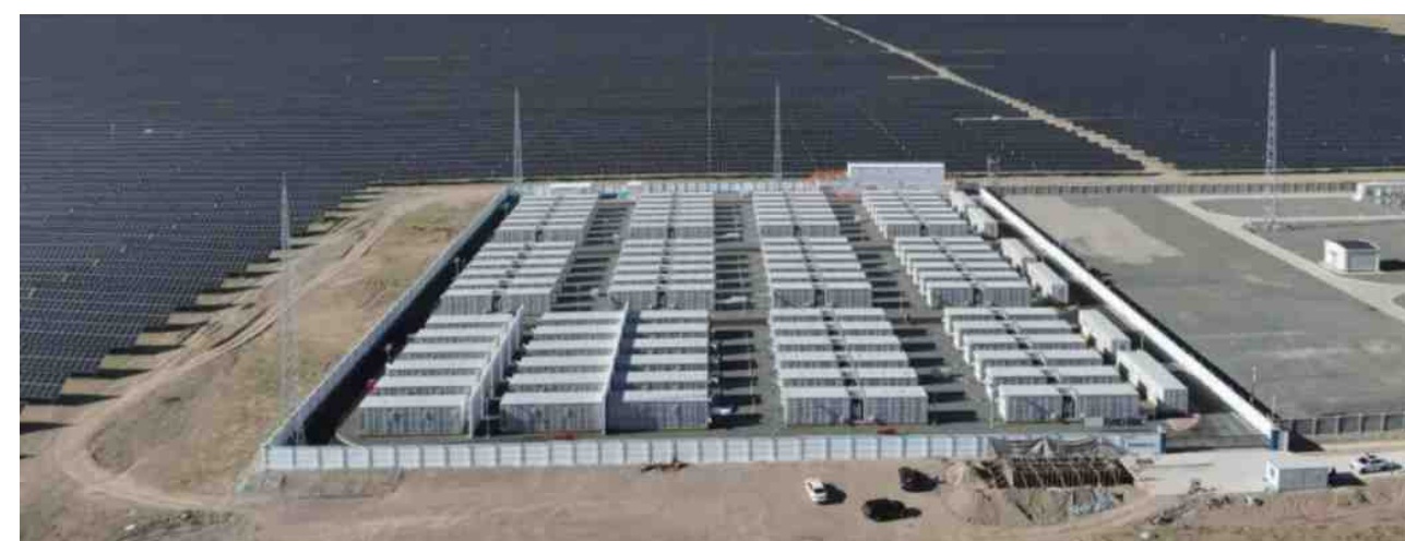
图 3.6-6 华能海南州共享储能项目
