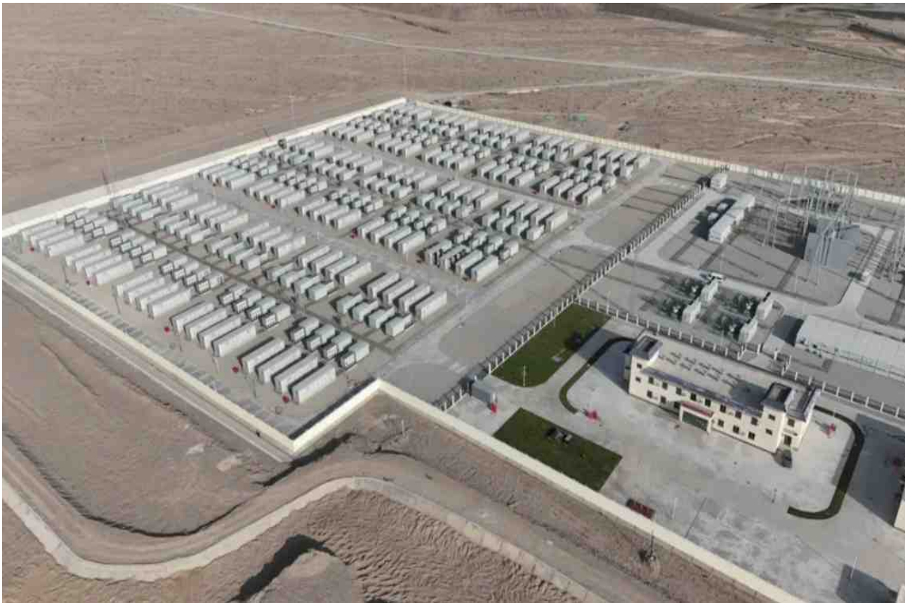
图 3.6-8 新疆克州构网型独立储能项目
