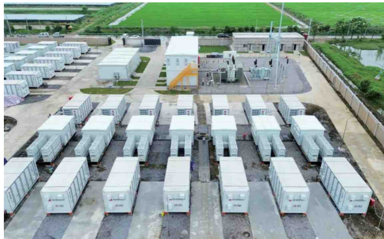
图 3.3-8 大唐湖北钠离子新型储能电站一期（50MW/100MWh）
