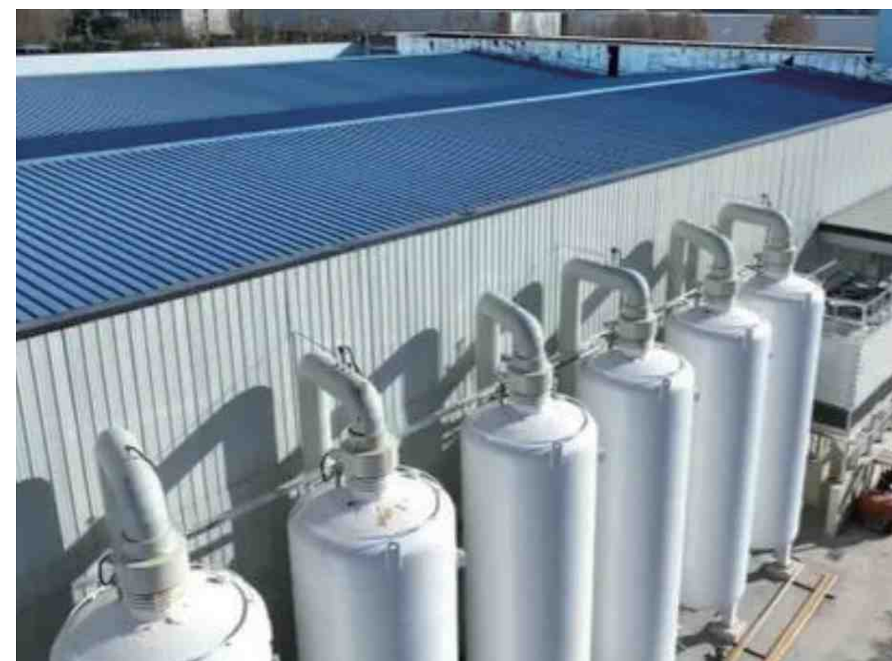
图 3.3-4 河北 1MW 液态压缩空气储能示范项目
