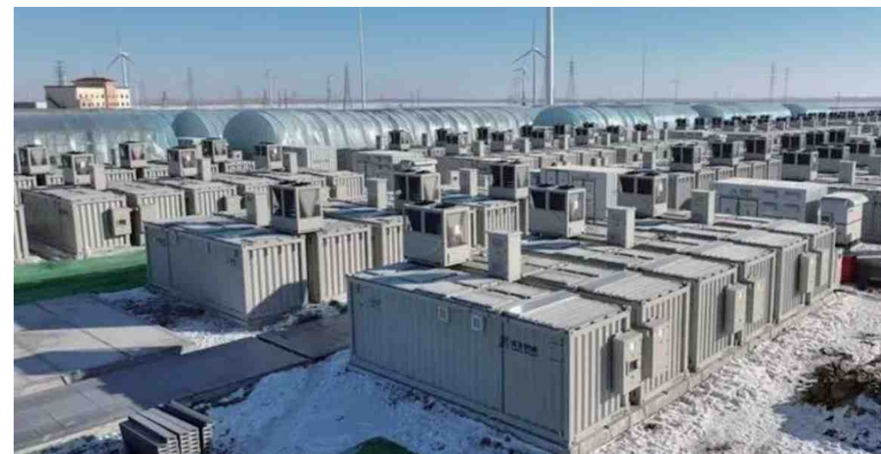
图 3.6-5 乾安中卉玉字全钒液流电池共享储能
