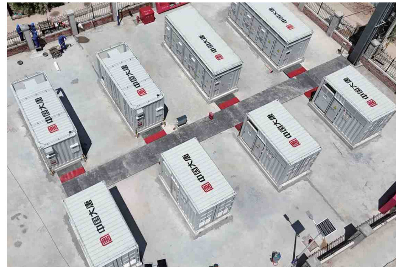
图 3.3-6 山东大唐鲁北公司 9MW/5MWh 混合储能调频项目
