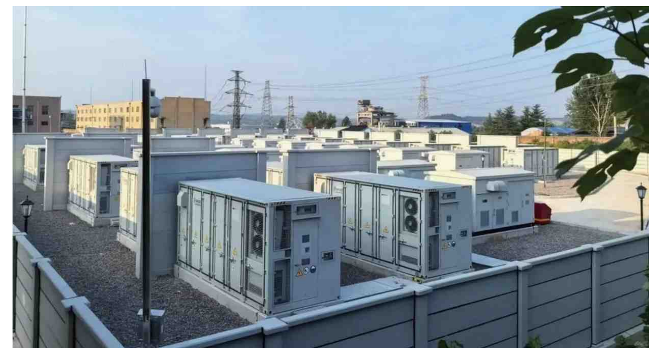
图 3.2-6 河南嵩基用户侧储能（45MW/133MWh）
