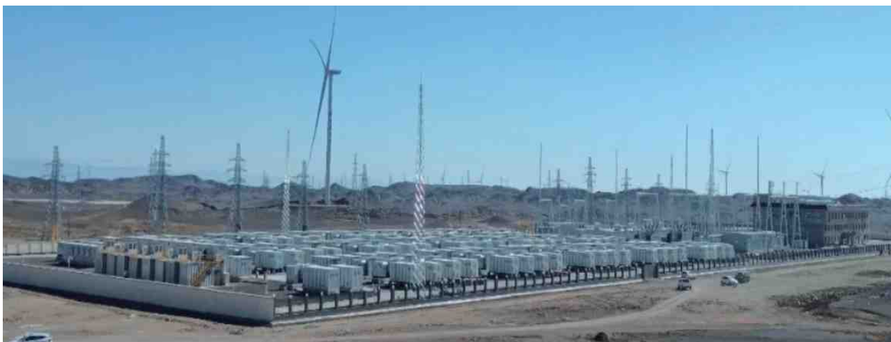
图 3.2-4 中电建新疆巴里坤储能项目（156MW/624MWh）
