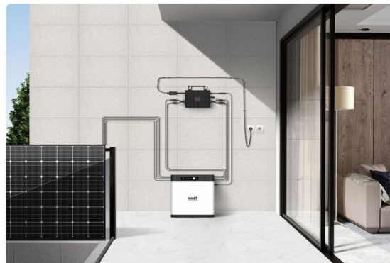
图 13：阳台光伏储能主要包括发电、转换及存储等模块
