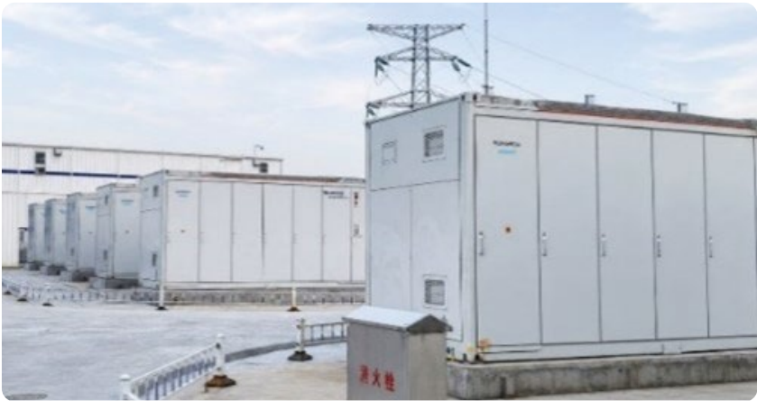
图19 云南文山50MW/100MWh构网型储能项目
