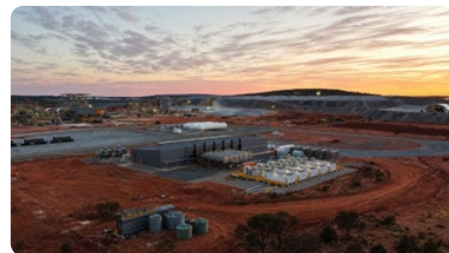
图38 澳大利亚最大矿山微电网项目
