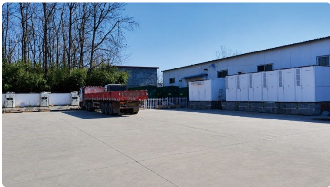
图33 河南新蔡重卡充电站
