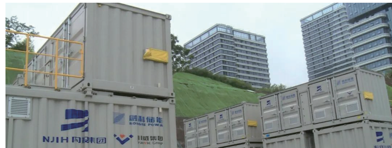
图 9-19 四川省内江市工商业全钒液流电池储能示范项目
