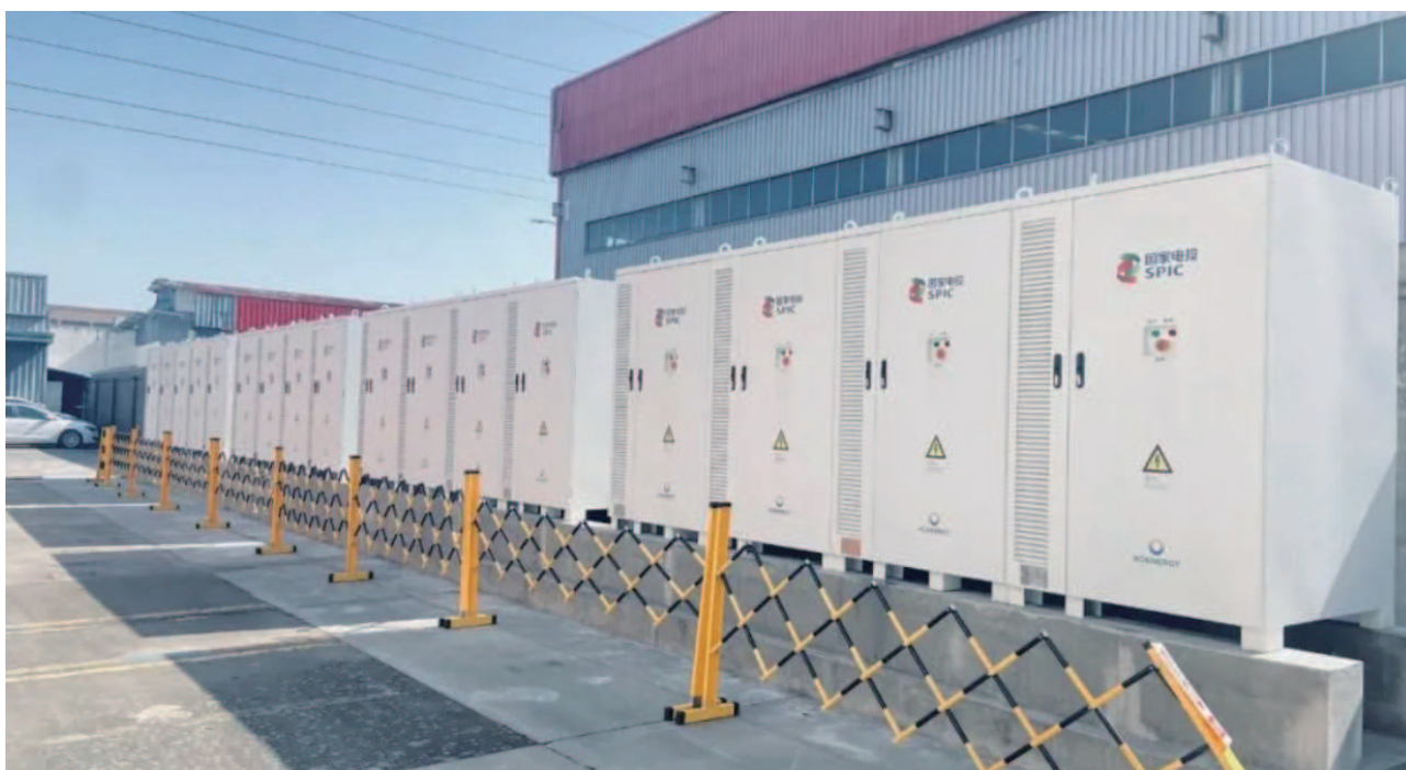
图 9-15 宁波慈溪 1.7MW/3.655MWh 用户侧液冷储能项目
