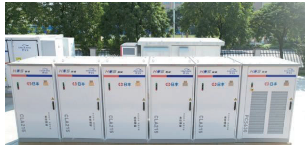
图 9-8 日丰企业（佛山）有限公司 19MWh 储能项目
