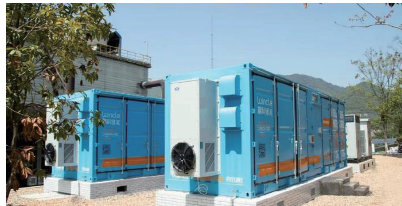
图 9-3 葛洲坝石门特种水泥有限公司储能项目
