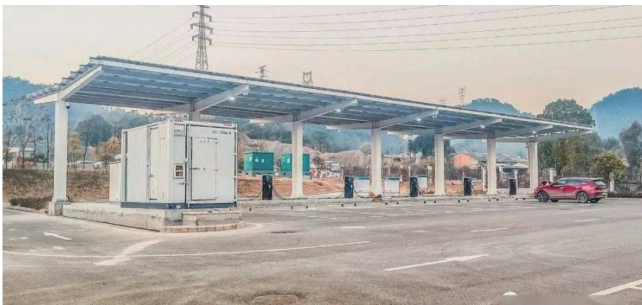
图 9-11 湖北黄石绿色客运站光储充一体化项目
