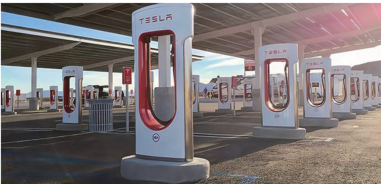
图 9-12 上海特斯拉光储充一体化充电站
