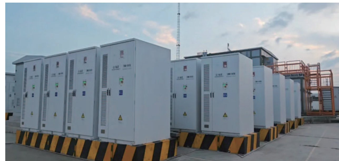
图 9-5 马鞍山市粤美金属制品 46MWh 工商业储能
