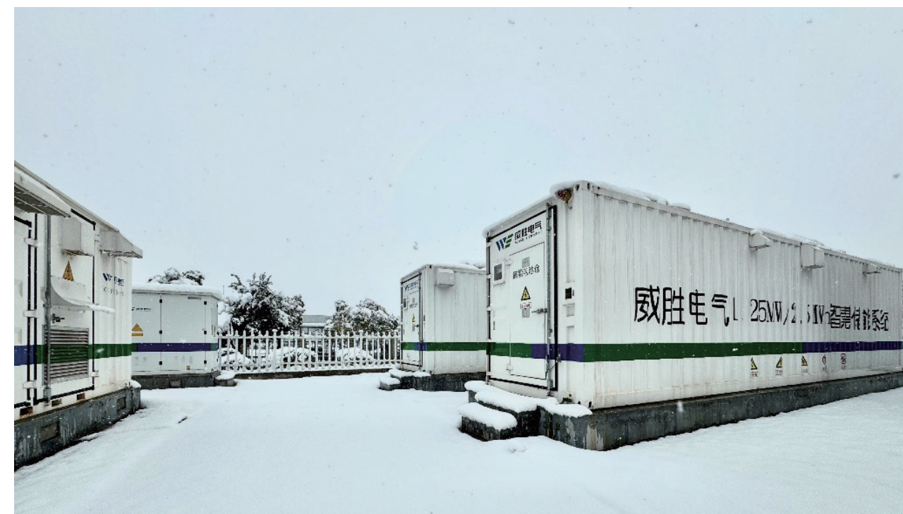
图 9-16 湘潭经开区增量配电网红东储能电站
