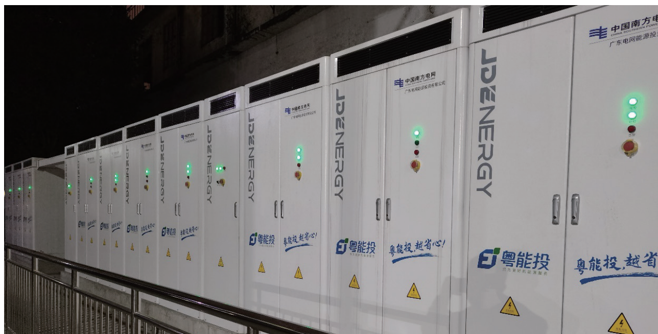
图 9-17 佛山南海区工商业储能项目
