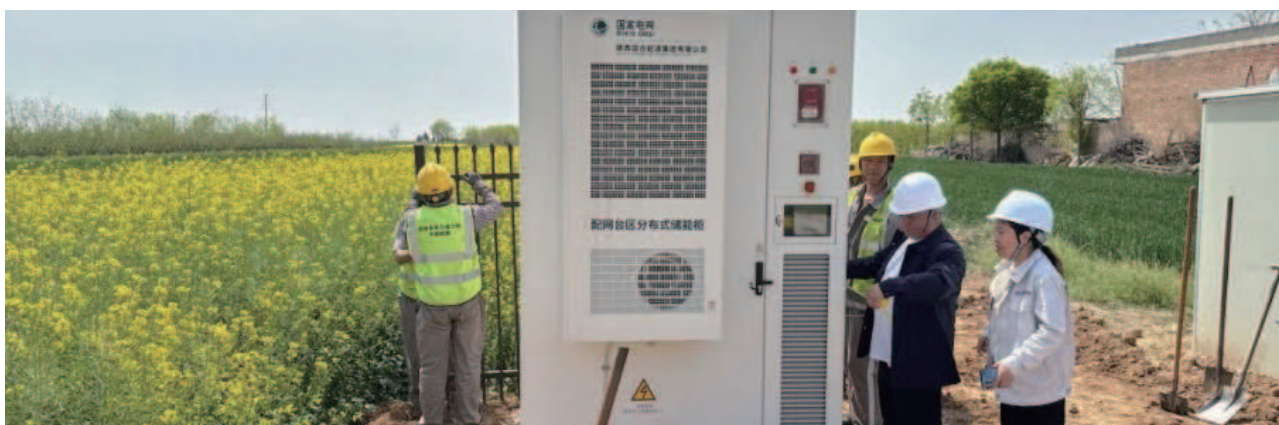
图 9-13 陕西省 14.1MW/30.0MWh 台区分布式储能项目
