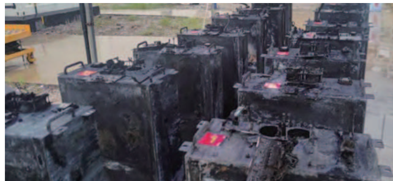
图 8-3 海南某市农光互补型光伏储能电站预制舱发生火灾
