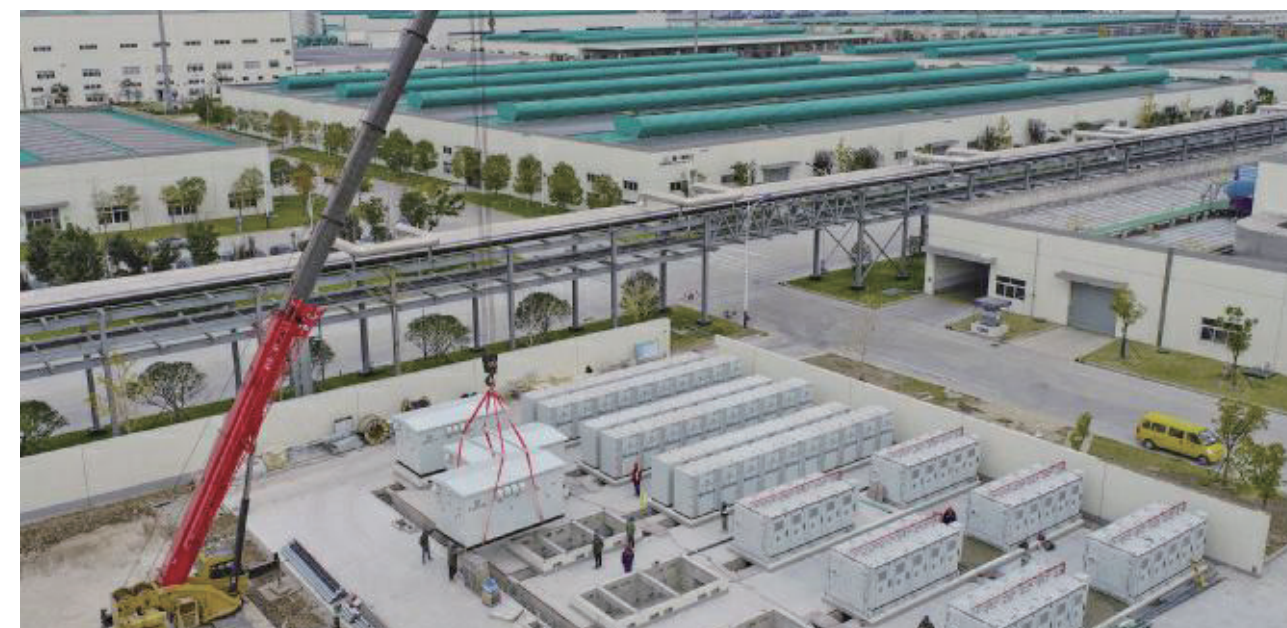
图 9-10 南通市通州区 20MW/40MWh 工商业储能项目
