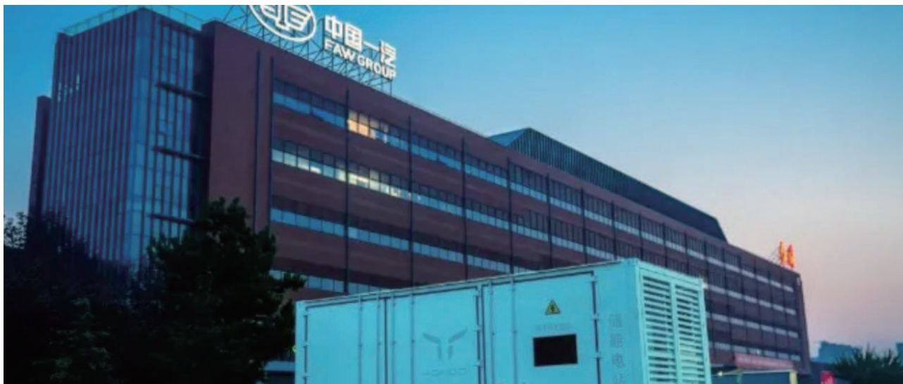
图 9-7 中国一汽梯次电池储能电站
