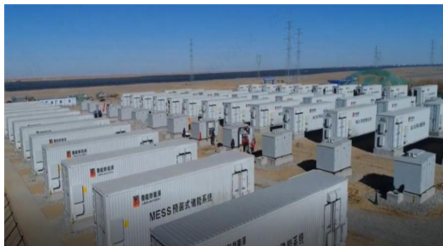
图 8：宁德时代鲁能国家级储能电站示范工程
