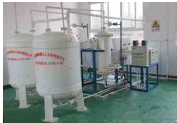
液流电池储能系统实物图
