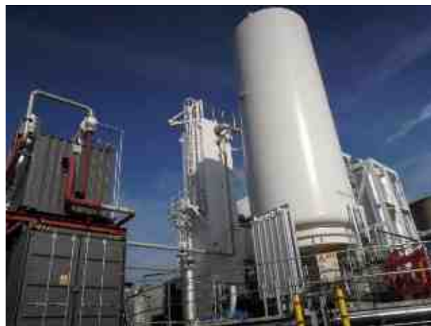
深冷液态空气储能试验系统
