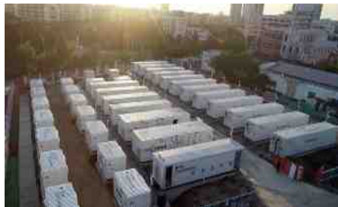
江苏镇江东部储能示范工程
