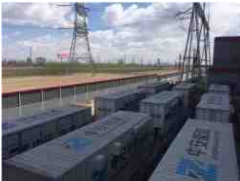
科陆山西同达9MW/4. 478MWh AGC调频项目
