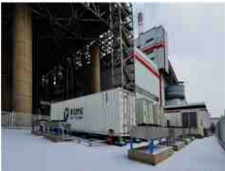
山西京玉热电厂储能联合调频项目
