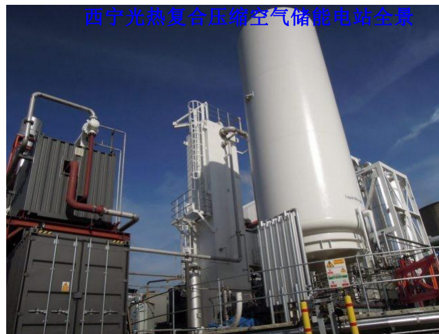
Highview液态空气储能电站
