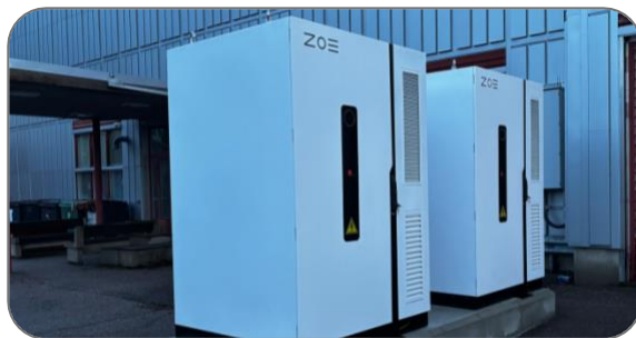
波兰微电网项目
