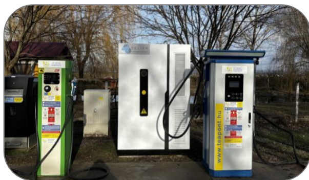
瑞典光伏+电池储能+电动汽车充电项目
