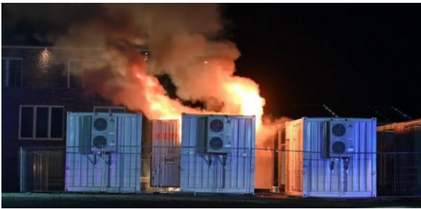
图3. 德国尼尔莫尔商业区储能起火 柜门炸开导致2名消防员受伤 9
