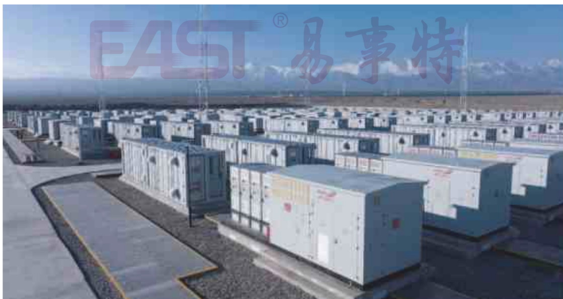
图 17 新疆克州 300MW/1200MWh 构网型独立储能项目
