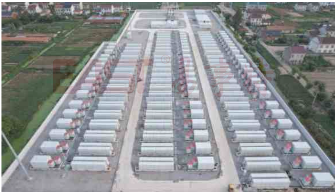
图 19 江苏启东 150MW/300MWh 独立储能电站
