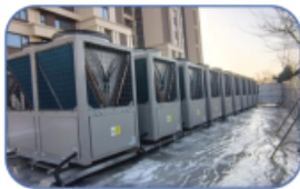
空气源热泵机组
