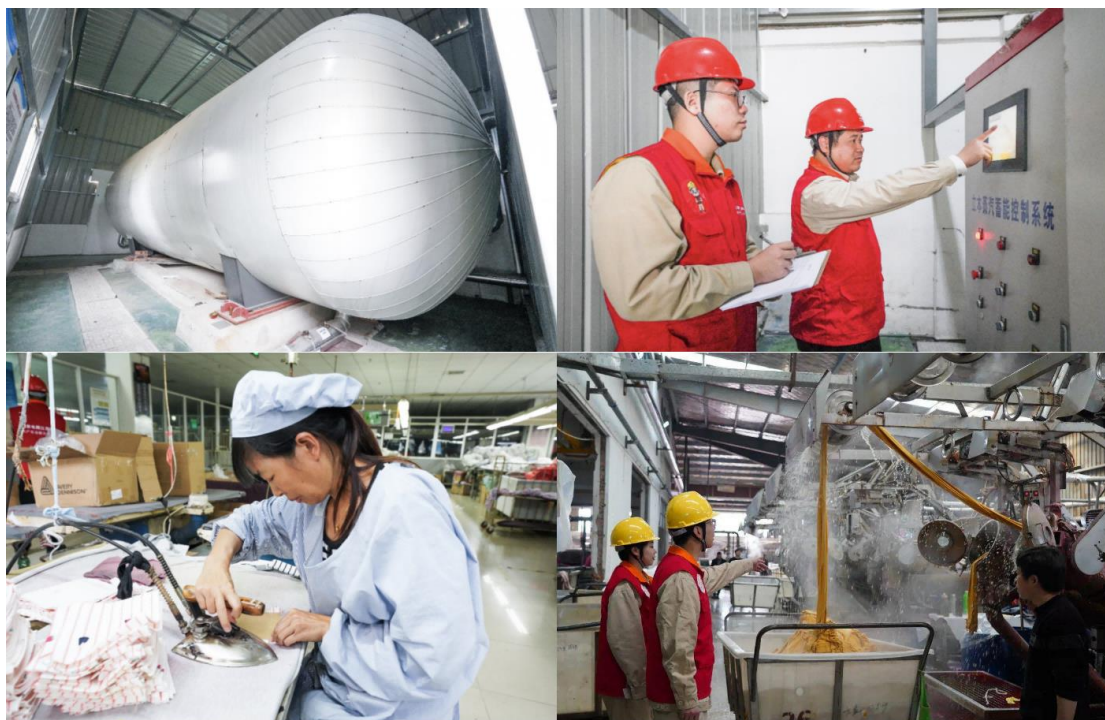
图 5-45：该针织厂内蒸汽储热罐、现场调试及生产用热过程实景图
