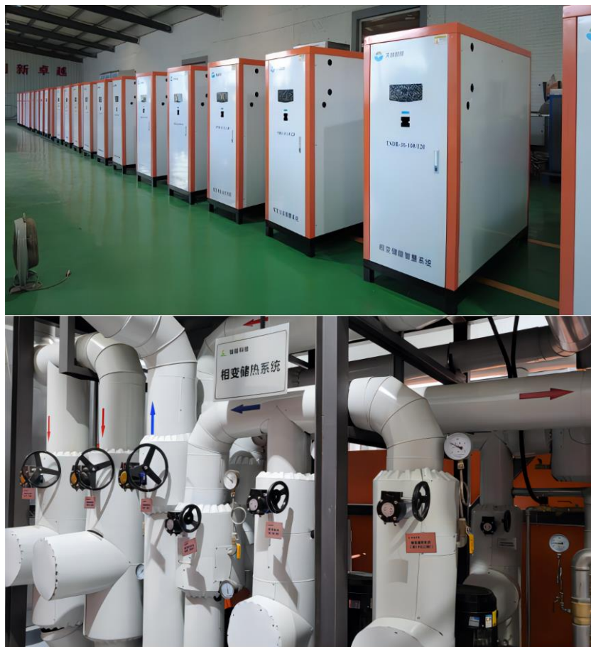
图 5-21：辽宁邮电智慧相变蓄热储能系统实景图
