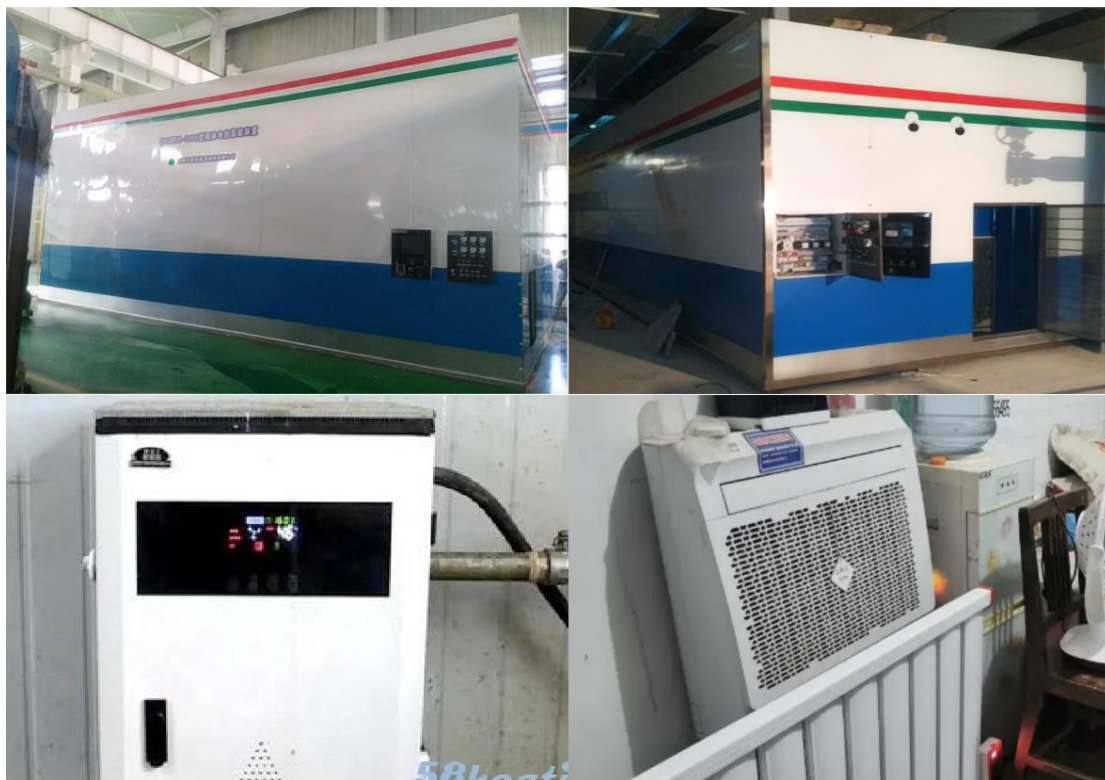
图 5-26：新疆阿勒泰市阿苇滩镇供暖项目及居民家中“煤改电”采暖设备实景图
