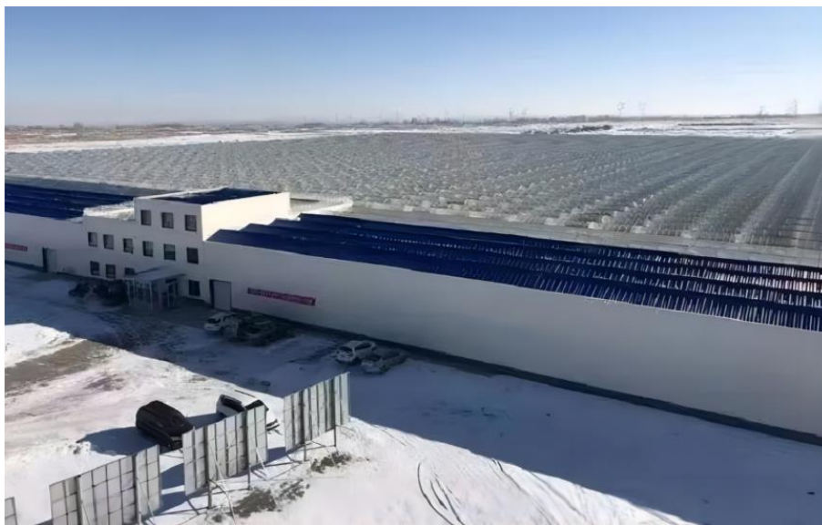
图 5-48：敦煌种业玻璃温室电蓄热供暖项目实景图
