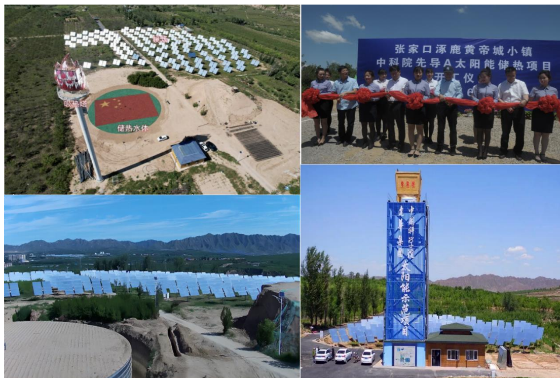
图 5-12：张家口涿鹿县太阳能塔式跨季节水体储热供热示范项目实景图
