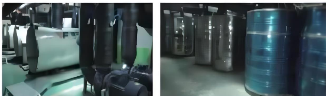
图 5-9：谷电蓄热供暖系统现场
