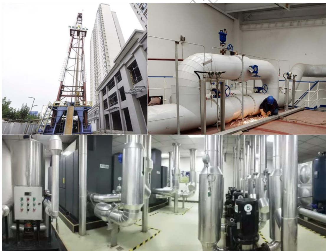
图 5-38：项目施工现场及地热供热机房实景图
