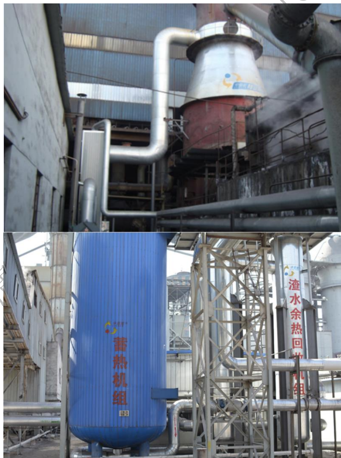
图 5-46：项目蒸汽负压余热回收装置和蓄热机组实景图
