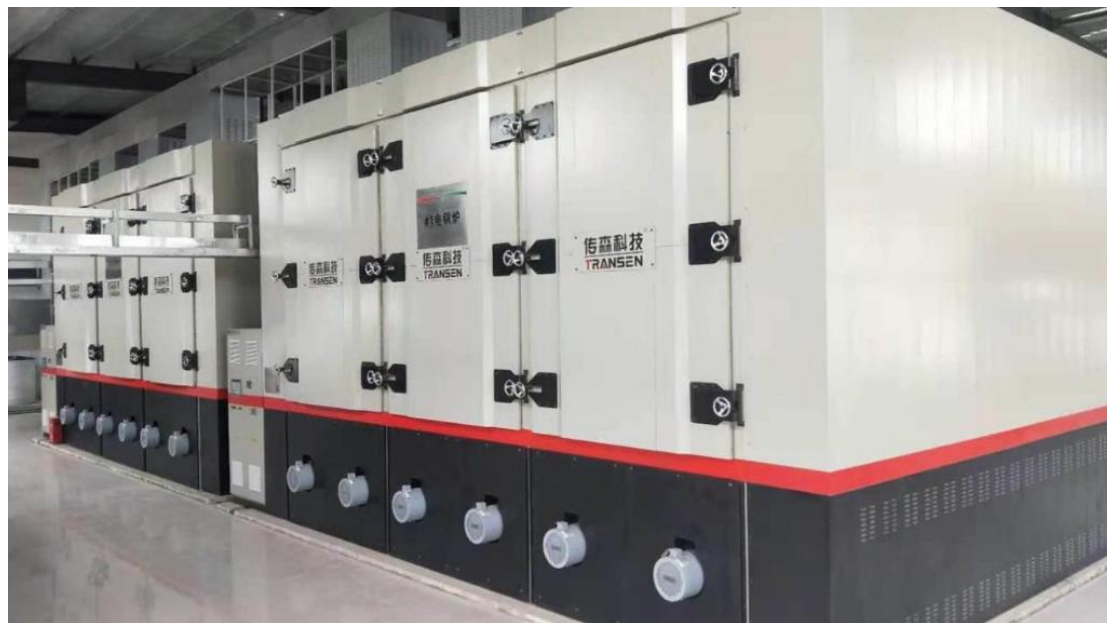
图 5-29：项目固体蓄热机组
