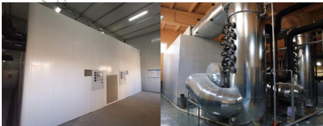
图 5-28：项目固体电蓄热设备
