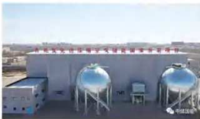
先进绝热压缩空气储能电站
