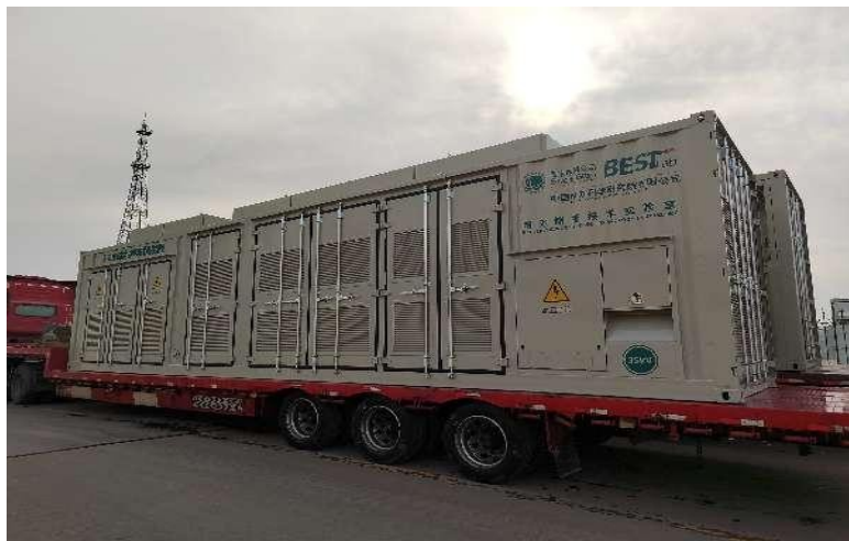
35kV/9MW 并网测试平台
