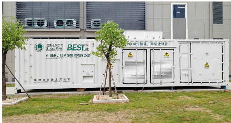
10(6)kV/6MW 并网测试平台
